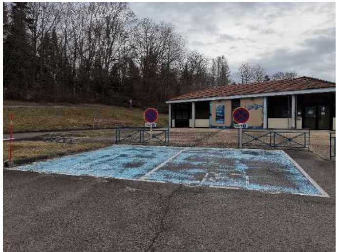
Parking piscine - marquage partiellement effacé - parking situé sur terrain CCPM
