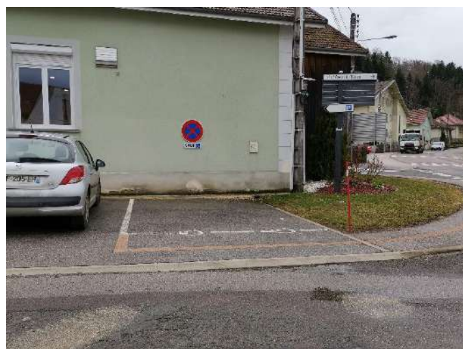
Salle de l'Union – Marquage partiellement effacé
