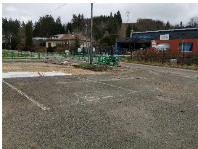
Stade des Tuileries – 3 places prévues – absence de signalisation verticale et marquage effacé
